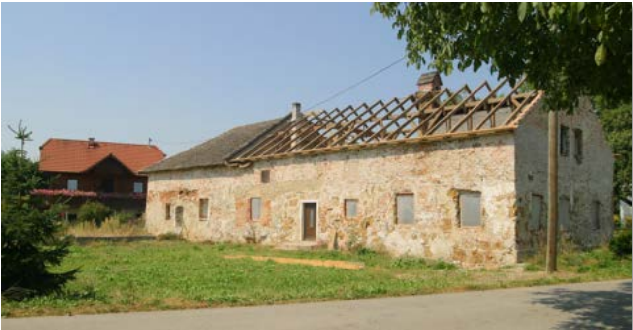
Abb. 159: Demolierter Amonhof nach dem Hochwasser vom August 2002 aufgenommen im August 2004 von Südost nach der Absiedlung
